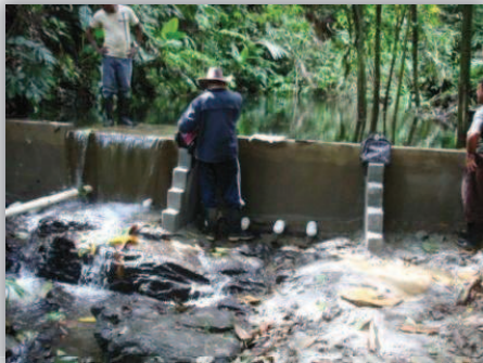
Toma de agua en la comunidad de Palmira en Costa Abajo Colón y de Caimito en Costa Abajo Colón
