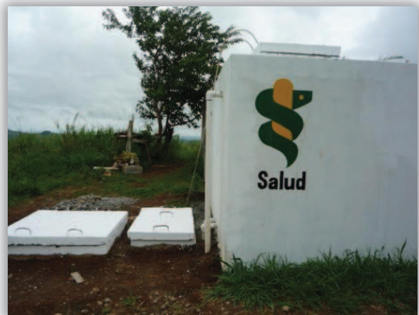
Tanque de Almacenamiento con sus respectivas cajas protectoras para la válvula de limpieza y la válvula de control para la línea de salida.
