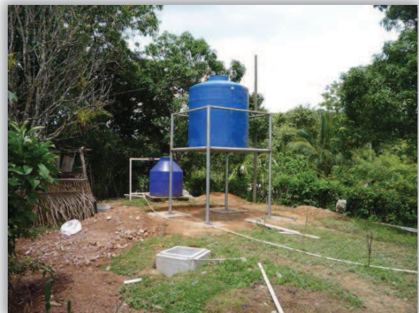
Tanque de Almacenamiento de Plástico, sobre Torre y Suelo.
